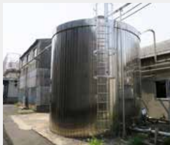
高温水回収タンク(蒸気ドレンや染色時の冷却水など、直接ワークに触れていない高温水が回収される)
